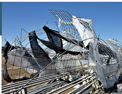
パーストダウンによる突風被害の様子
