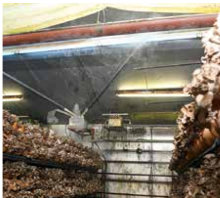
▲断続的に霧を噴出し、発生室の湿度を保持します
